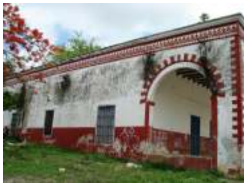
Fotografía 3. Vista de fachada lateral: se observan manchas de moho y deterioro de pintura.
