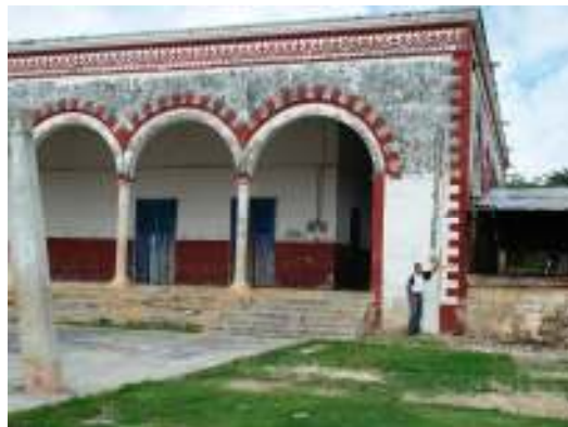
Fotografía 2. Se observa manchas de moho en muros y elementos decorativos.
