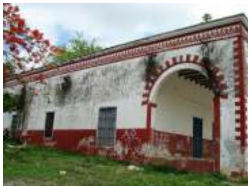
Fotografía 3. Vista de fachada lateral: se observan manchas de moho y deterioro de pintura.
