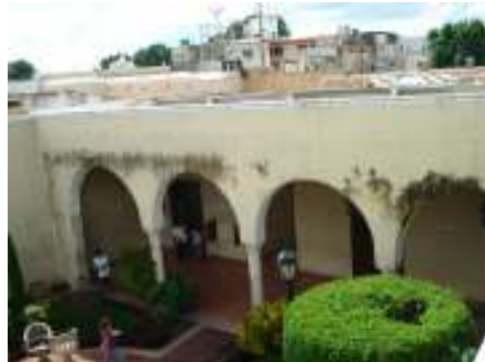
Fotografía 2. Muro sur, patio interior, se observan manchas y costras de humedad.
