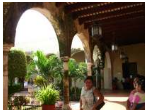
Fotografía 4. Corredor poniente, se observa manchas de moho y líquenes en muros y columnas.
