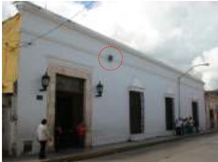
Fotografía 1. Vista de la fachada principal, se observa crecimiento de vegetación nociva en la cornisa y desprendimiento de pintura
