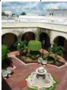
Fotografía 3. Muros norte y poniente, patio interior. Se observa costras de microorganismos
