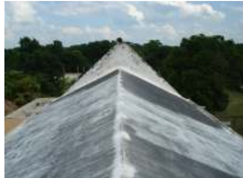
Fotografía 2. Vista de la azotea, de la fachada principal hacia el presbiterio, se observa un sistema de impermeabilización acrílica con falta de mantenimiento.
