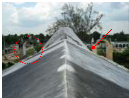
Fotografía 3. Vista de la azotea, desde el presbiterio hacia la fachada principal, se observa crecimiento de vegetación nociva.
