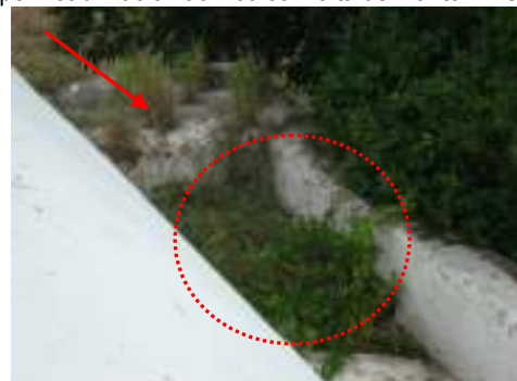
Fotografía 4. Detalle de bajante pluvial en azotea de la sacristía, existe acumulación de basura y crecimiento de vegetación nociva.
