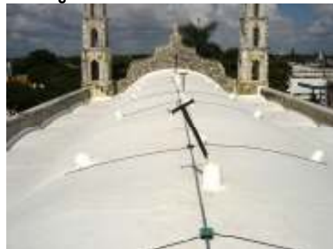
Fotografía 4. Vista general de la azotea del templo. Se observa la existencia de un sistema de impermeabilización acrílico.
