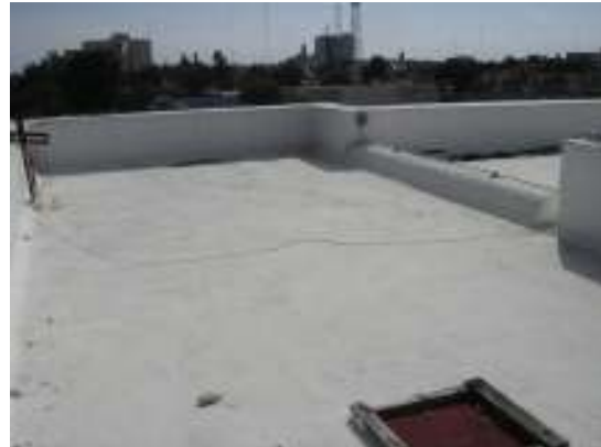
Fotografía 2. Vista de la azotea. Se observan áreas sin el sistema de impermeabilización
