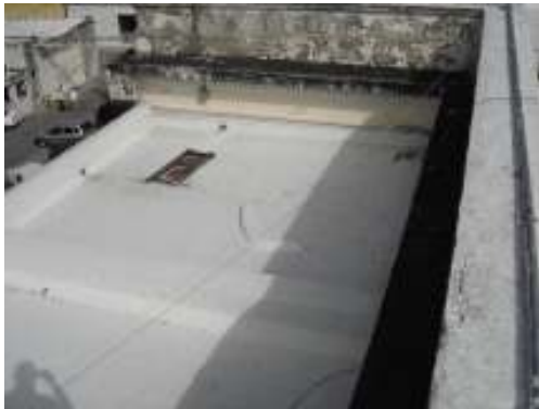
Fotografía 3. Vista de las cornisas. Se observa el acabado superior deteriorado
