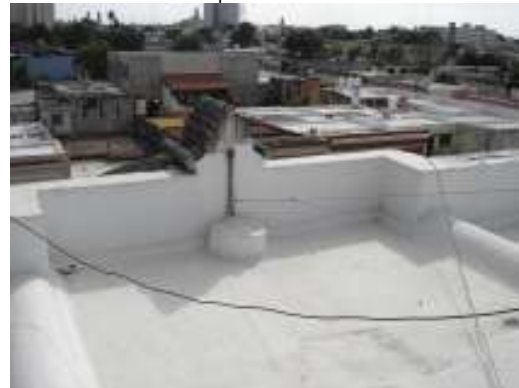
Fotografía 4. Vista de la azotea. Se observa cableado expuesto a la intemperie
