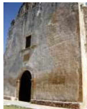
Fotografía 4. Detalle en fachada. Se observa falta de acabados y pintura.
