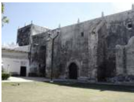
Fotografía 3. Vista del muro lateral. Se observa manchas y costras negras de humedad.
