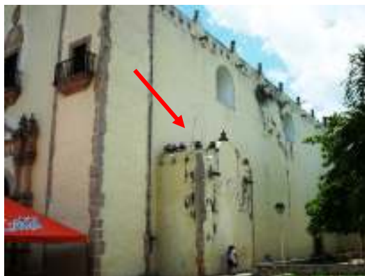
Fotografía 3. Fachada Lateral Sur. Existe crecimiento de vegetación nociva en muros.
