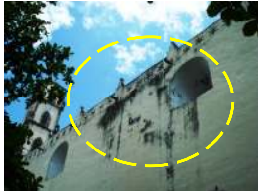
Fotografía 2. Detalle en muro lateral sur. Se observa manchas de humedad por escurrimiento.
