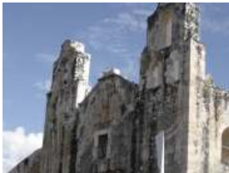
Fotografía 3. Vista cercana de los muros de fachada. Se observa manchas negras de humedad.
