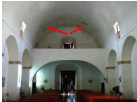
Fotografía 4. Vista del interior al coro desde el presbiterio. Se observa desprendimiento de acabado en bóveda.
