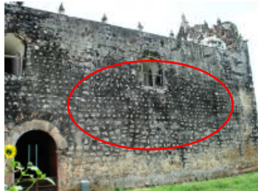
Fotografía 2. Vista de la fachada norte. Se observan manchas de humedad en muro.
