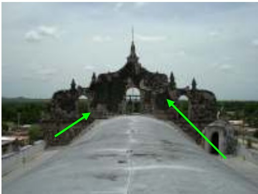
Fotografía 3. Vista de la espadaña. Se observa desprendimiento en los acabados y costras.
