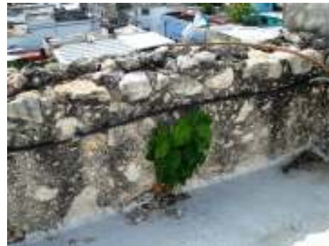
Fotografía 4. Detalle de crecimiento de vegetación nociva en pretilos del templo.
