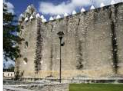
Fotografía 2. Vista lateral del Templo. Se observa humedad en muros.
