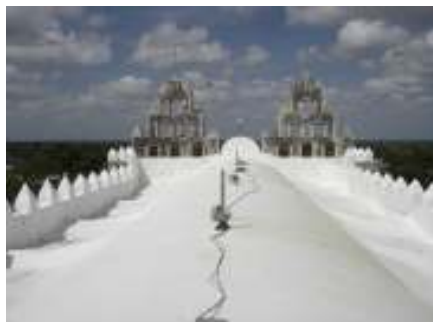
Fotografía 3. Vista del pararrayos. Se observan dañados los postes que sostienen las puntas de atracción
