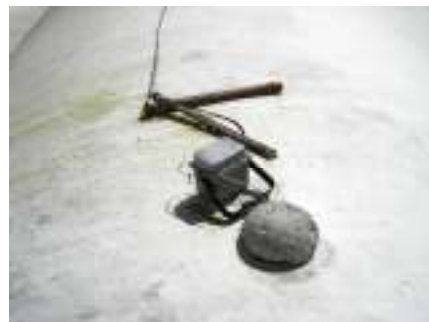
Fotografía 4. Detalle del pararrayos dañado.
