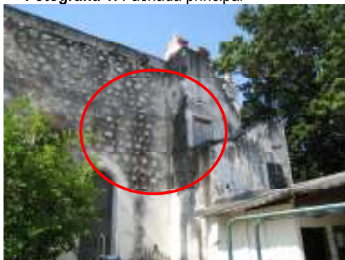
Fotografía 3. Detalle en muro. Se observa manchas por humedad.
