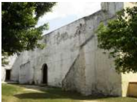
Fotografía 3. Vista de muro lateral. Se observa falta de acabados.
