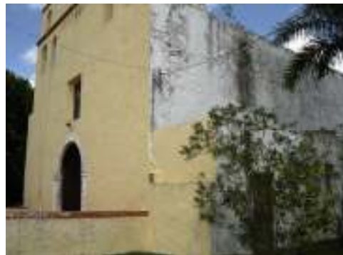
Fotografía 2. Vista del muro lateral. Se observa manchas de humedad.
