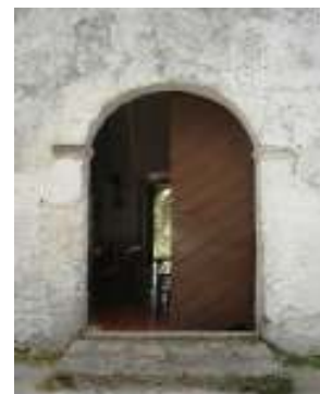
Fotografía 4. Vista de puerta lateral. Se observa falta de mantenimiento en pintura.
