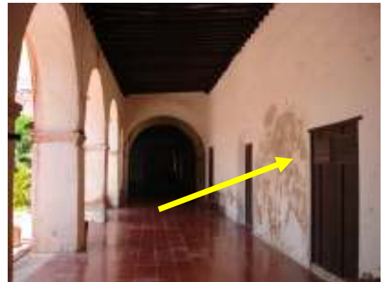
Fotografía 4. Detalle en muro del corredor del claustro. Se observa en muro desprendimiento de pintura.
