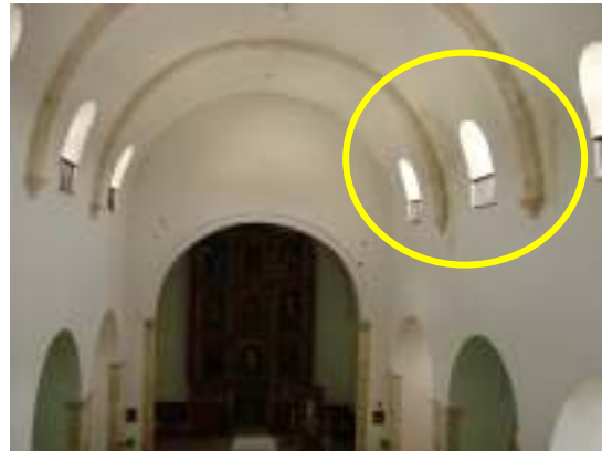
Fotografía 2. Vista del coro hacia el presbiterio. Se observa manchas de humedad en bóveda.
