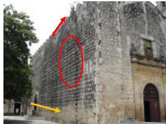
Fotografía 2. Vista de Fachada Norte. Se observa manchas de humedad, desprendimiento de acabado y vegetación en la parte superior del muro.
