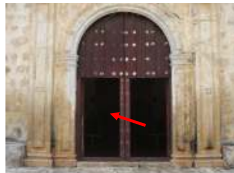
Fotografía 4. Detalle de Carpintería. Se observa deterioro y decoloración.
