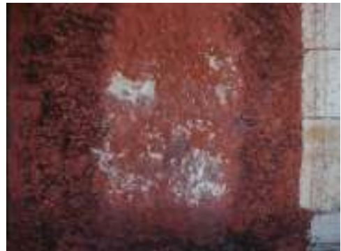
Fotografía 3. Detalle un muro. Se observa desprendimiento de acabado por humedad.
