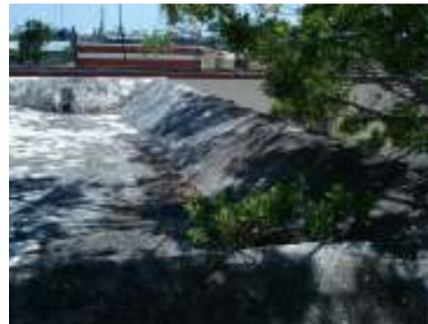
Fotografía 4. Vista de azotea. Se observa manchas por humedad.
