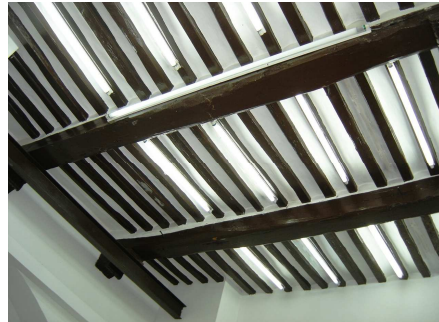
Fotografía 2. Vista de la techumbre. Se observa que es de vigas y viguetillas de madera.
